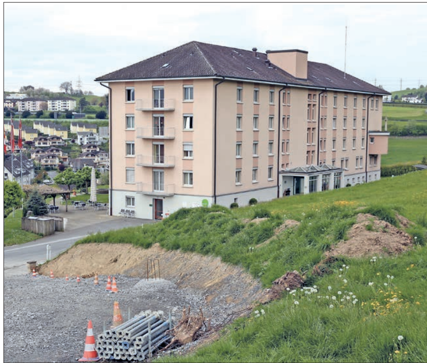
Geht es nach dem Bezirk, wird das Alters- und Pflegeheim Sunnehof künftig von der Cofely AG mit Seewärme beheizt.
