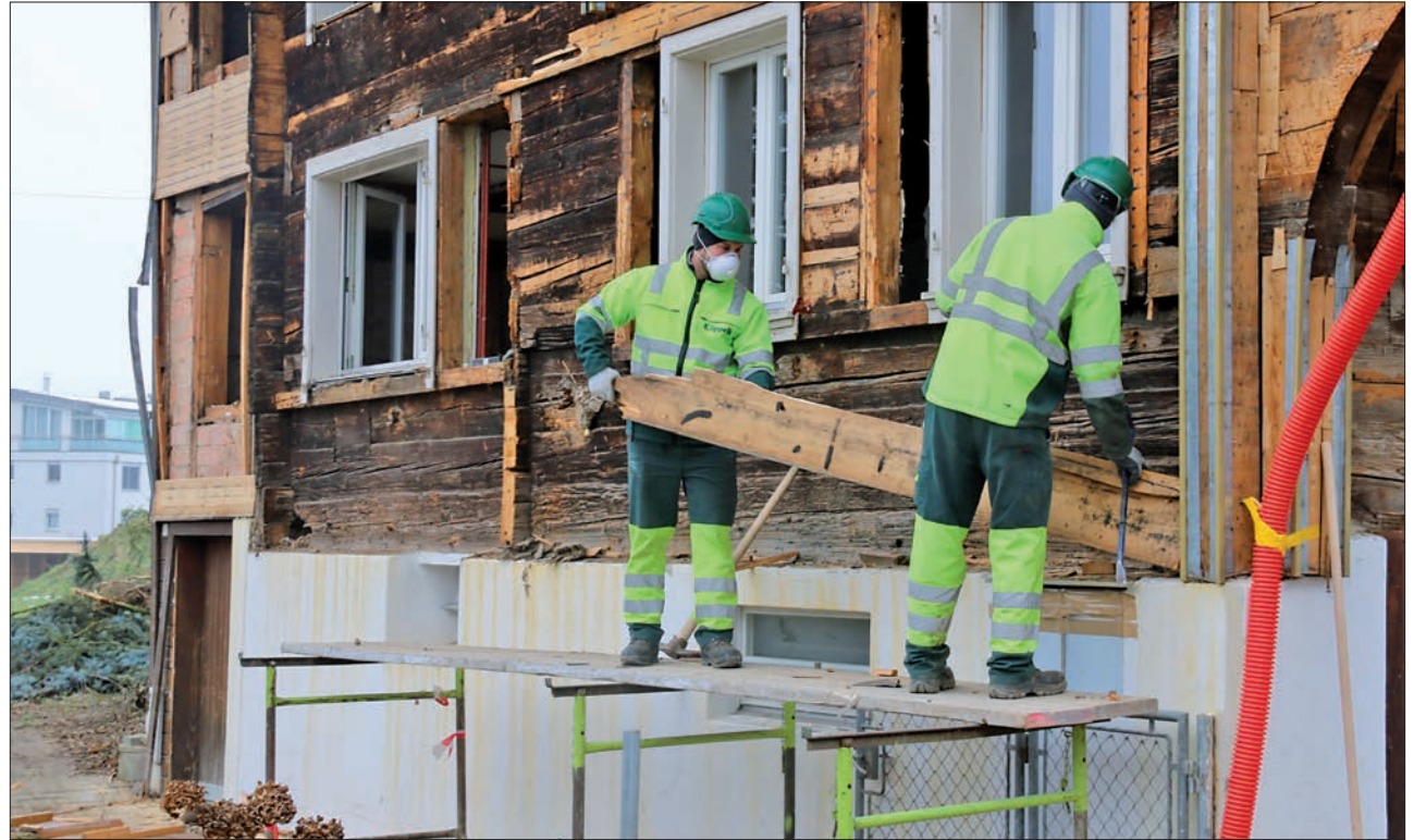
Am Fassbind-Haus werden zurzeit die Anbauten und Fassaden entfernt. Dabei kommt schrittweise der 435-jährige Holzbau im Kern des Gebäudes ans Licht. Foto: Fabian Duss
