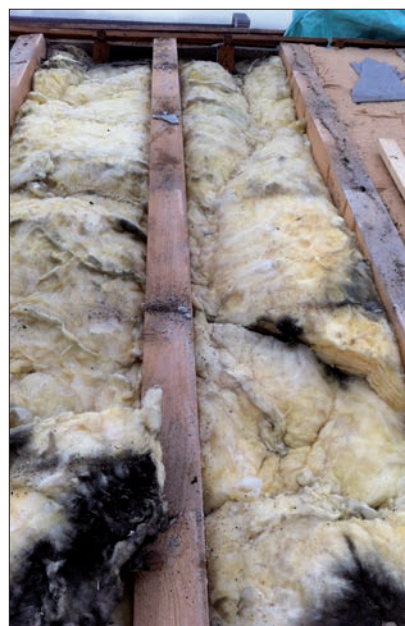
Die Sanierungsarbeiten beim Monséjour – Zentrum am See sind bereits in vollem Gange. Einerseits soll das Dach wegen Marderschäden saniert, andererseits eine Photovoltaik- und eine thermische Anlage eingebaut werden.
