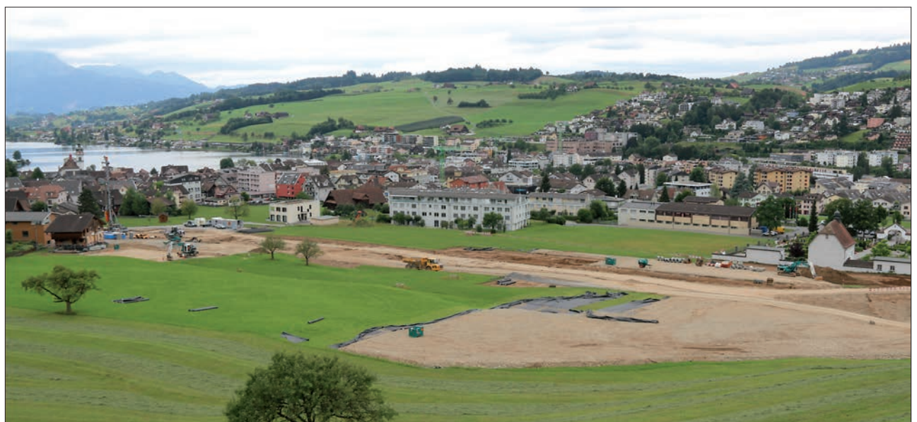
Die Bauarbeiten am nördlichen Tunnelportal der Südumfahrung kommen voran. Im Vordergrund die Deponie, dahinter das Strassentrassée mit dem künftigen Installationsplatz. Links, beim Fassbind-Haus, stehen bald die Baubüros. Foto: fab
